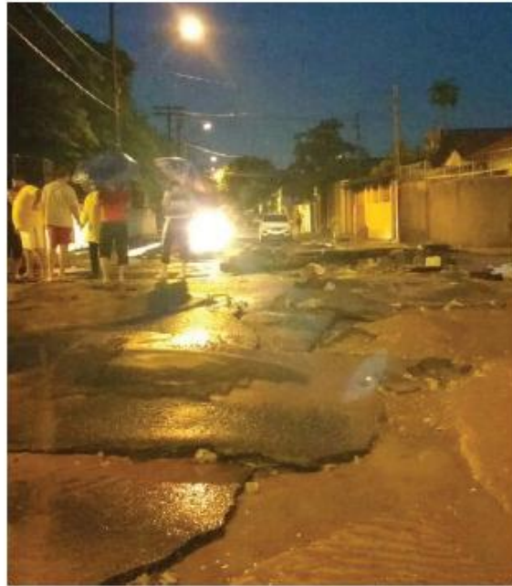
Enxurrada arrancou asfalto na rua José Miguel, na Vila Paulista
