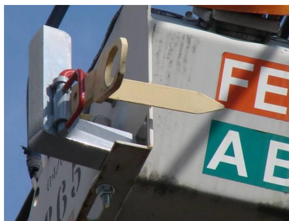
Figura 4 - Chave a óleo com fechamento para cima, com a trava instalada
